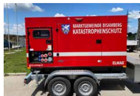
Foto: Notstromaggregat Bisamberg
