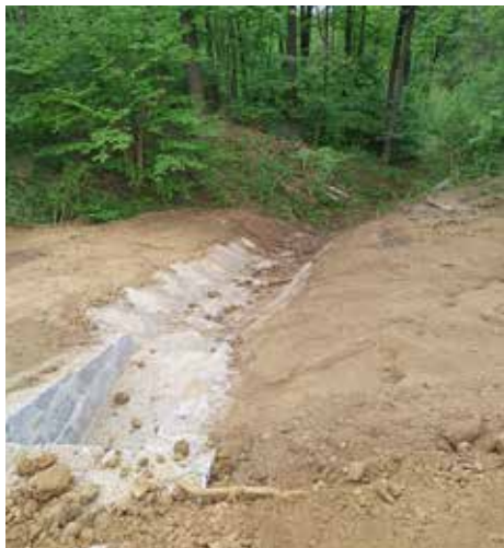
Foto: © R. Sitz, Geregelter Abfluss Becken Gamshöhe
